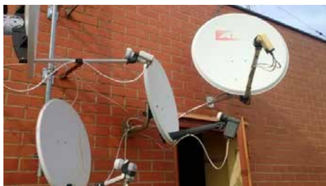
Proliferación antenas individuales en azotea
