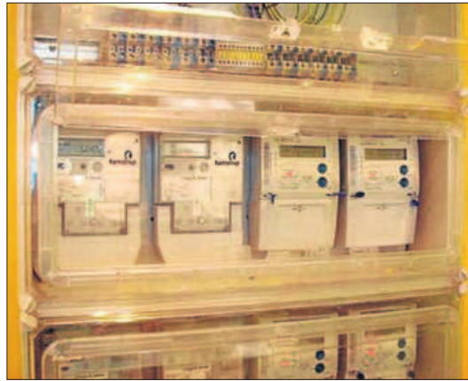
Imagen de los contadores nuevos instalados. INFORMACIÓN
