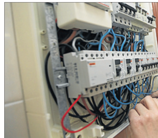
Las instalaciones eléctricas de los servicios comunes
